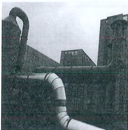
图 4-7 粉针车间废气处理设施
