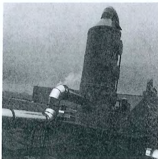
图 4-6 固体二车间废气处理设施
