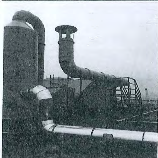
图 4-3 研发楼废气处理设施
